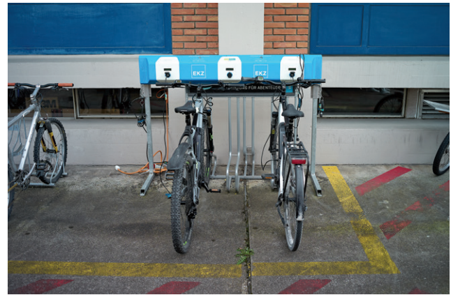
Fig. 22 : Rack avec prises de recharge (source : EKZ).
