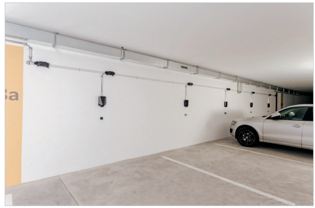
Fig. 51 : Installation extensible avec borne easee et plaques dorsales dans un parking souterrain (source : ewz).
