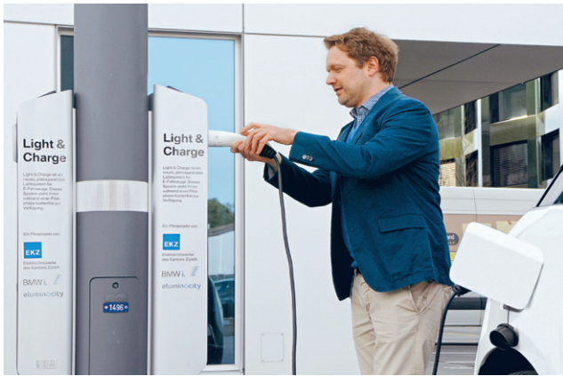
Fig. 5 : Les bornes lampadaires sont fixées sur les lampadaires d'éclairage public (source : EKZ).
