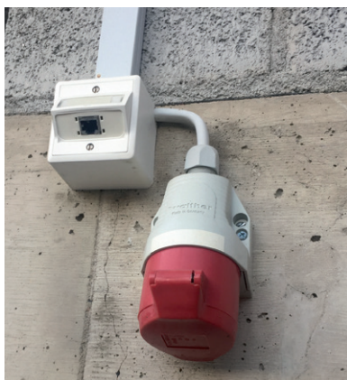
Fig. 47 : Dispositif optimal pour une future borne de recharge avec prise CEE et connexion LAN pour l'insertion de la borne de recharge dans un système de gestion des recharges et/ou d'accès et de paiement.
