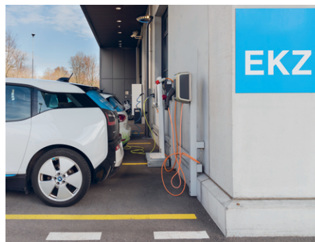
Fig. 36 : Borne de recharge normale/accélérée pour places de parkings visiteurs/clients à l'extérieur (source : EKZ).
