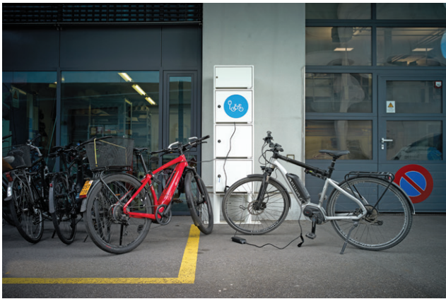
Abb. 21: Schliessfach mit integrierter Steckdosen zum Laden (Quelle: EKZ).
