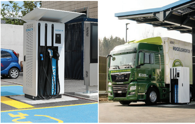
Abb. 44: Beispiel von Ladestationen mit Vordach (Quelle: Gofast).
