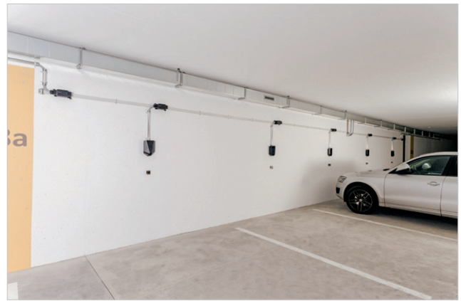
Abb. 51: Skalierbare Installation in einer Tiefgarage mit easee Stationen basierend auf Rückplatten (Quelle: ewz).
