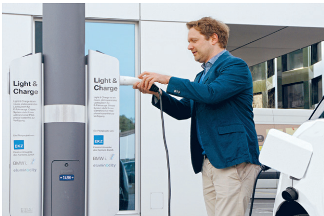
Abb. 5: Kandelaber-Ladestationen sind an einem Lichtmast fixiert (Quelle: EKZ).
