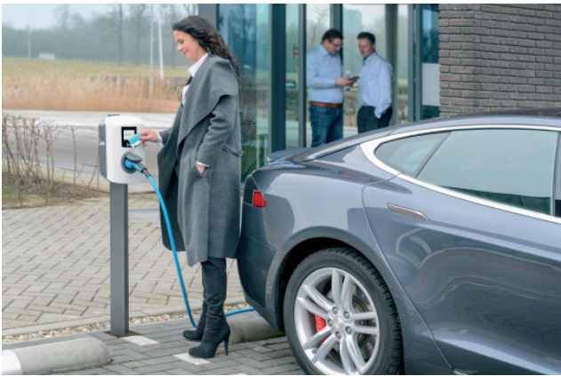
Abb. 55: Zugang zum Ladeprozess mit RFID – Alfen EVE Single Pro-Line (Quelle: Alfen).
