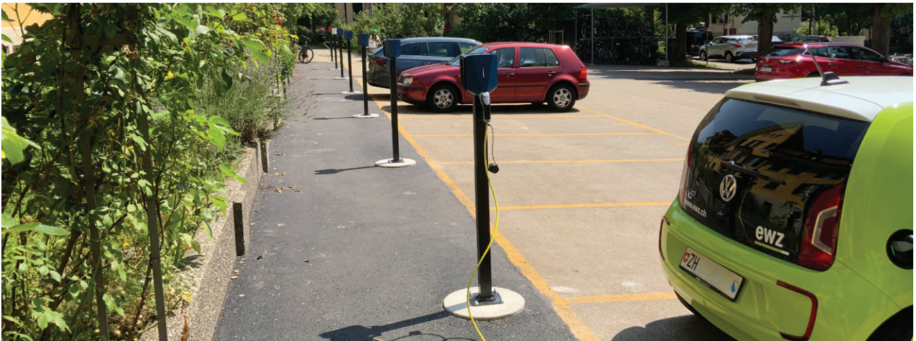
Parkplätze Stolzstrasse 30, Zürich (Quelle: ewz)
